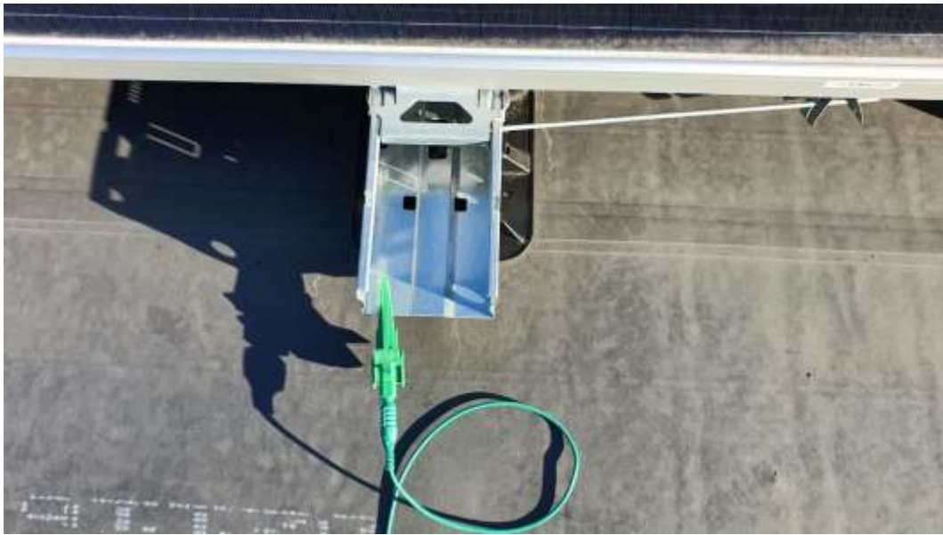
Afbeelding: aansluiting meetpunt op ligger
