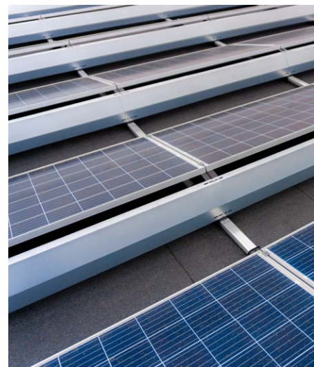
Het gewicht van de zonnepanelen is gelijkmatig over het dak verdeeld.
